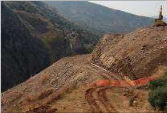
Figura 10 – Stato della discarica a pendio pre-intervento; la situazione era invariata da molte decine di anni. Fonte prati armati
