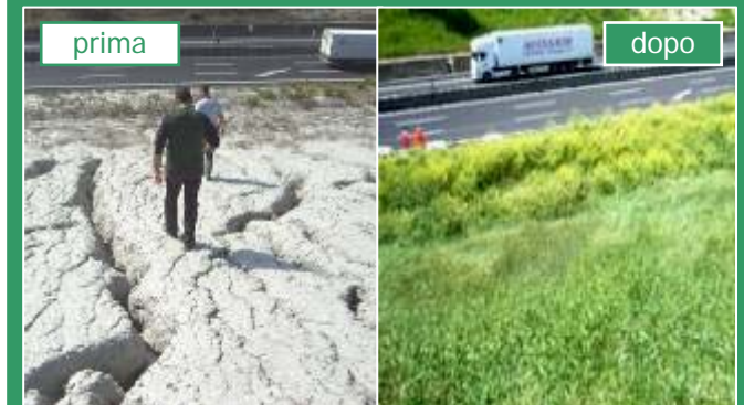
Autostrada del Sole (A1): argille plioceniche sovraconsolidate
