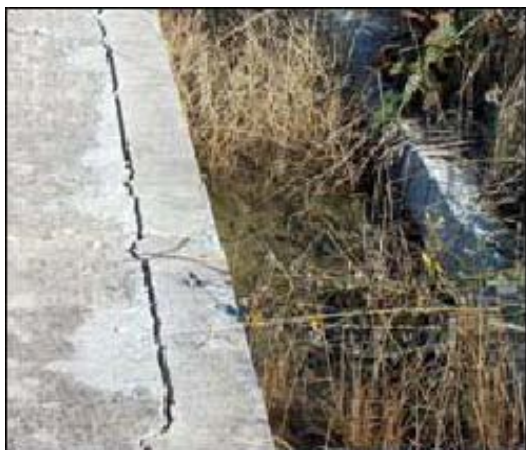
Ancona – canal înfundat în zona netratată cu PRATI ARMATI®
