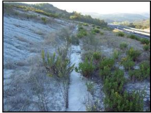
Figura 2: A1 Milano-Napoli: canaletta sempre intasata prima del trattamento (Fonte: Autostrade per l'Italia)
