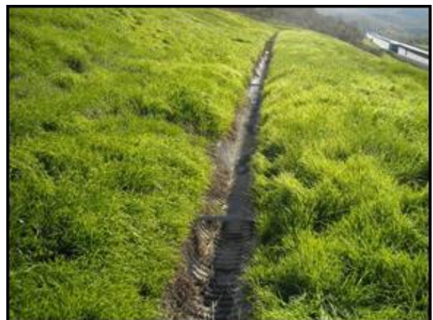
Figura 3: A1 Milano-Napoli: Canaletta perfettamente pulita dopo il trattamento (Fonte: Autostrade per l'Italia)
